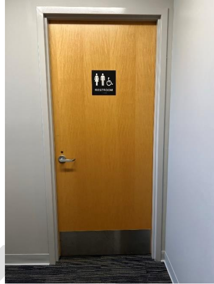
Unisex Restroom Door
