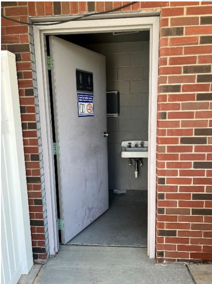
Unisex Restroom Door
